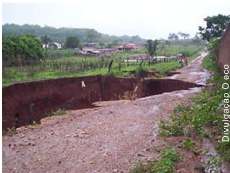
Buracos aparecem em Vazante
